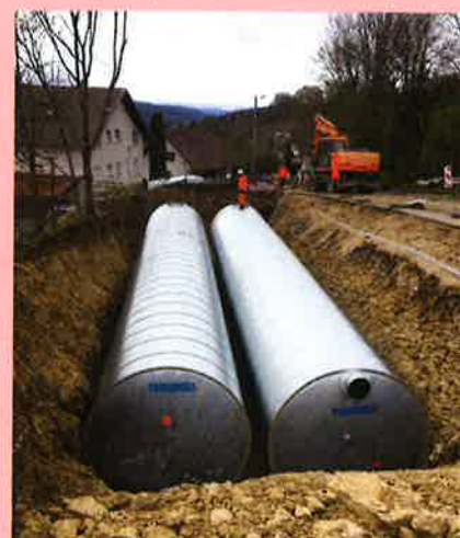
Cuves de rétention des eaux pluviales rue de la Forêt
